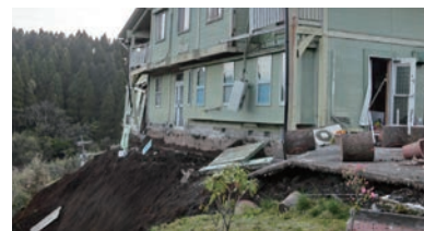
【写真2.3.1】敷地の西側がえぐり取られた建築物
