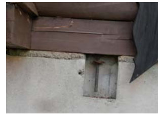
【写真2.2.4】 丸太の締め付けボルトの緩み
