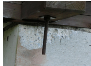
【写真2.2.5】 コンクリート基礎の軽微な損傷
