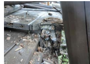
【写真2.2.3】 脱した独立柱脚部の腐朽
