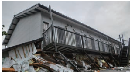
【写真2.4.4】 倒壊した共同住宅
