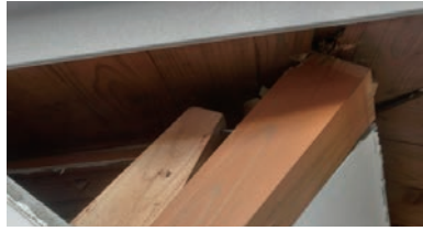
【写真4.2】写真4.1の筋かい端部のくぎ打ち接合
