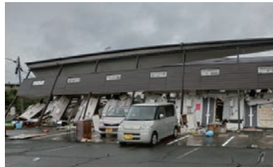
【写真2.4.1】 倒壊した共同住宅
