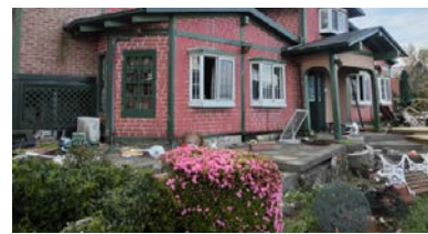
【写真2.3.2】崖下へ傾斜した木造宿泊施設
