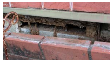
【写真2.3.3】写真2.3.2の建築物の躯体の腐朽
