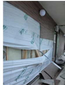
【写真2.4.7】 写真2.4.5の座屈した筋かい
