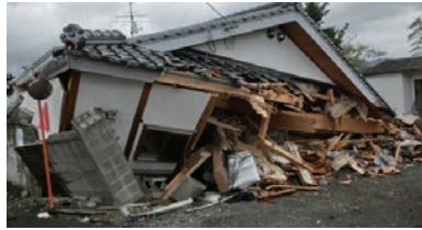
【写真4.1】比較的年数が浅い平屋建ての倒壊
