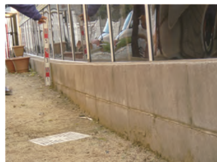
軟弱地盤に盛土して分譲地ができると、中央部に向かって湾曲する。
