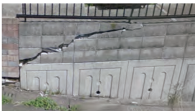
谷側の盛土が沈下したのでブロック壁が割れている。
