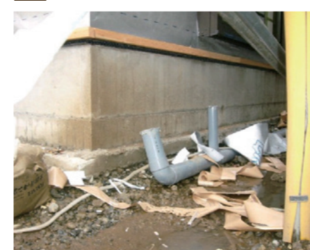
盛土荷重で地盤沈下し、基礎は浮上している。
